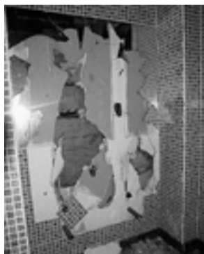
▲ Destrozos. Cristales y espejos rotos en los vestuarios. :: ARMANDO MÉNDEZ
