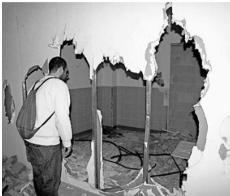
▲ Vestuarios. Un residente recorre el interior del módulo de vestuarios. Se acumulan suciedad, restos de material y destrozos de todo tipo. Ya no están los extintores y los servicios también han sido víctima de robos y vandalismo. :: ARMANDO MÉNDEZ
