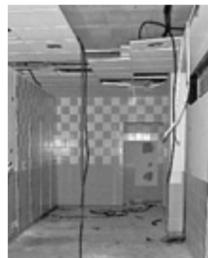
▲ Sin techo. Paredes y techos rotos en el módulo interior. :: A. MÉNDEZ
